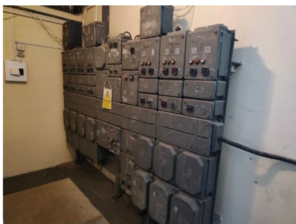
Fot. 22: Obecny stan wyposażenia Stacji Uzdatniania Wody w Piątkowie
