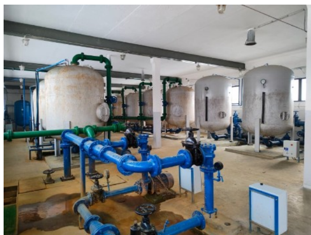
Fot. 21: Obecny stan wyposażenia Stacji Uzdatniania Wody w Piątkowie
