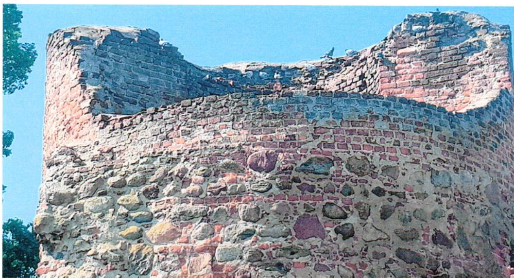
Fot. 31. Korona baszty południowej – widoczne uszkodzenia korony, dezintegracja spoin i ceramiki budowlanej, uszkodzone cementowe naprawy oraz licznie gniazdujące ptactwo
