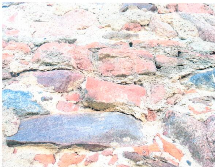
Fot. 34. Baszta południowa (fragment muru w partii przyziemia) – widoczna silna dezintegracja zapraw spoinujących
