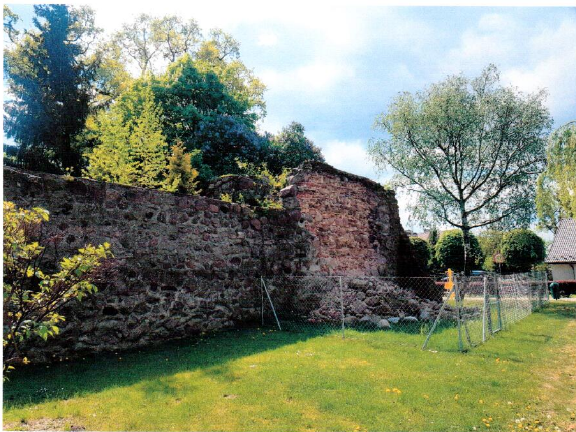
Fot. 40. Fragment zachodni muru przedzamcza południowego od strony ul. św. Mikołaja i Placu Wolności, stan po katastrofie budowlanej z zabezpieczonym fragmentem osuwiska
