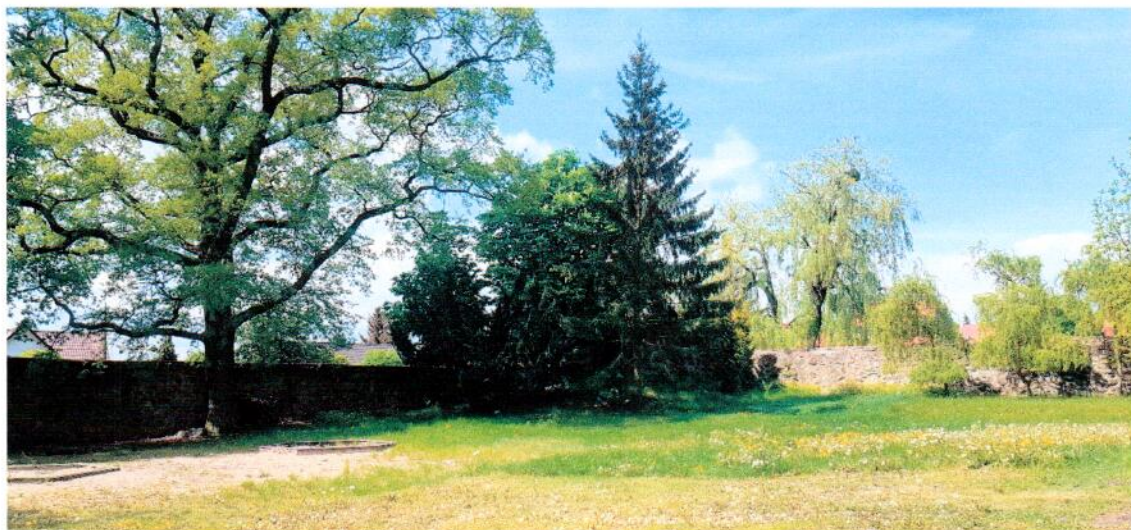
Fot. 44. Fragment muru przedzamcza południowego, narożnik południowo-zachodni, widok z dziedzińca przedszkola od strony północno-wschodniej. Uszkodzony narożnik muru od strony dziedzińca porośnięty jest kępą drzew i krzewów
