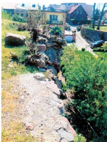
Fot. 18. Korona muru parczanu z widocznymi naprawami zaprawą cementową
