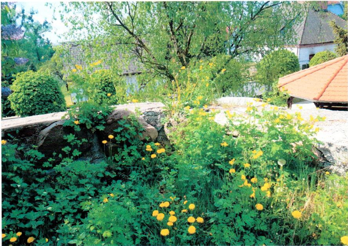
Fot. 47. Fragment korony uszkodzonego narożnika południowo-zachodniego muru przedzamcza południowego, widok z wnętrza dziedzińca działki przedszkola
