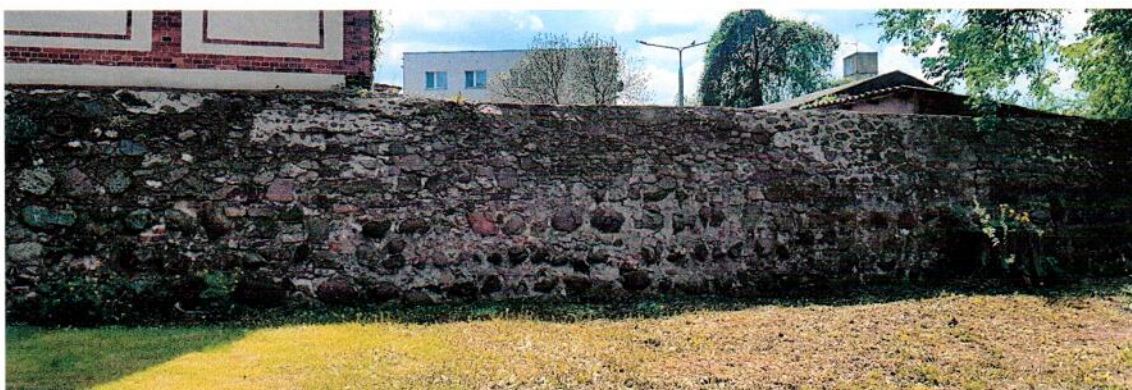
Fot. 30. Lico muru od strony dziedzińca przedzamcza południowego, widoczne spękania i atak mikrobiologiczny
