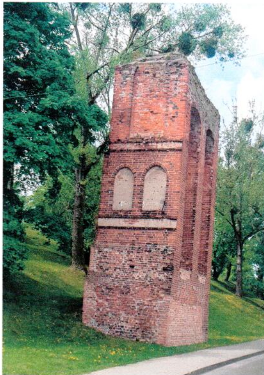
Fot. 11. Filar gdaniska zamku pochylony w stronę ul. Strażackiej, widok od strony wschodniej
