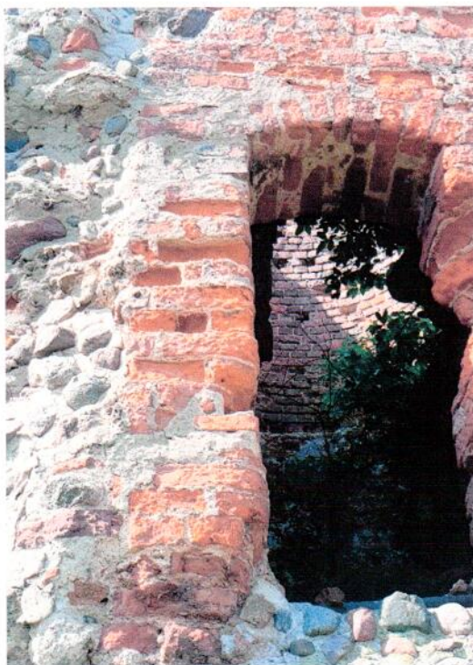
Fot. 32. Baszta południowa, wewnątrz porośnięte dziką roślinnością
