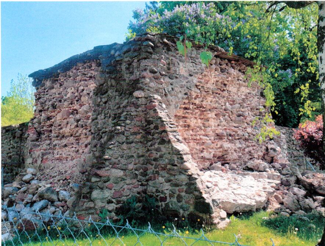
Fot. 41. Fragment narożny (południowo-zachodni) muru przedzamcza południowego od strony ul. Fosa Jagiellońska, stan po katastrofie budowlanej z zabezpieczonym fragmentem osuwiska
