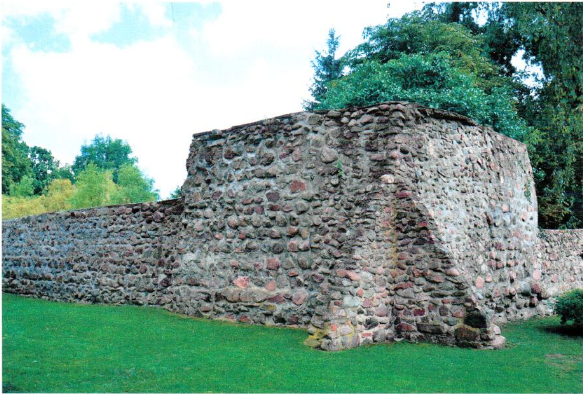
Fot. 37. Fragment narożny muru przedzamcza południowego od strony ul. Fosa Jagiellońska, stan przed katastrofą budowlaną, źródło z dnia 18.05.2022 r.: https://polska-org.pl/7689806,foto.html?idEntity=7628467
