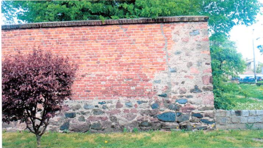
Fot. 29. Fragment muru przedzamcza południowego z uzupełnieniem ceglanym, widoczne spękania pionowe i ubytki w obrębie cegieł i spoin
