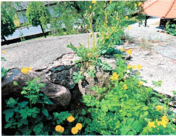
Fot. 26. Korona narożnika muru przedzamcza południowego – silny rozrost drobnej roślinności
