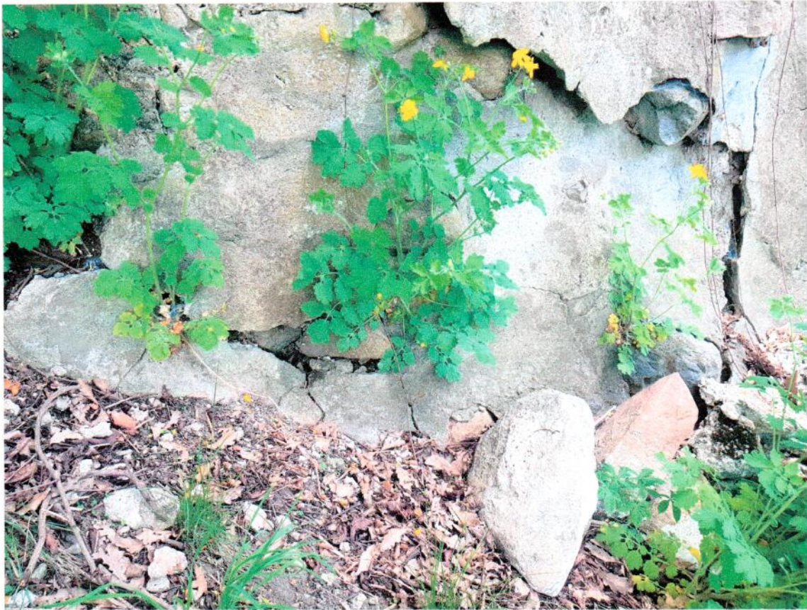
Fot. 49. Fragment muru przedzamcza południowego, narożnik południowo-zachodni, widok z dziedzińca przedszkola od strony północno-wschodniej. Stan cementowych napraw i umocnień w partii przyziemia
