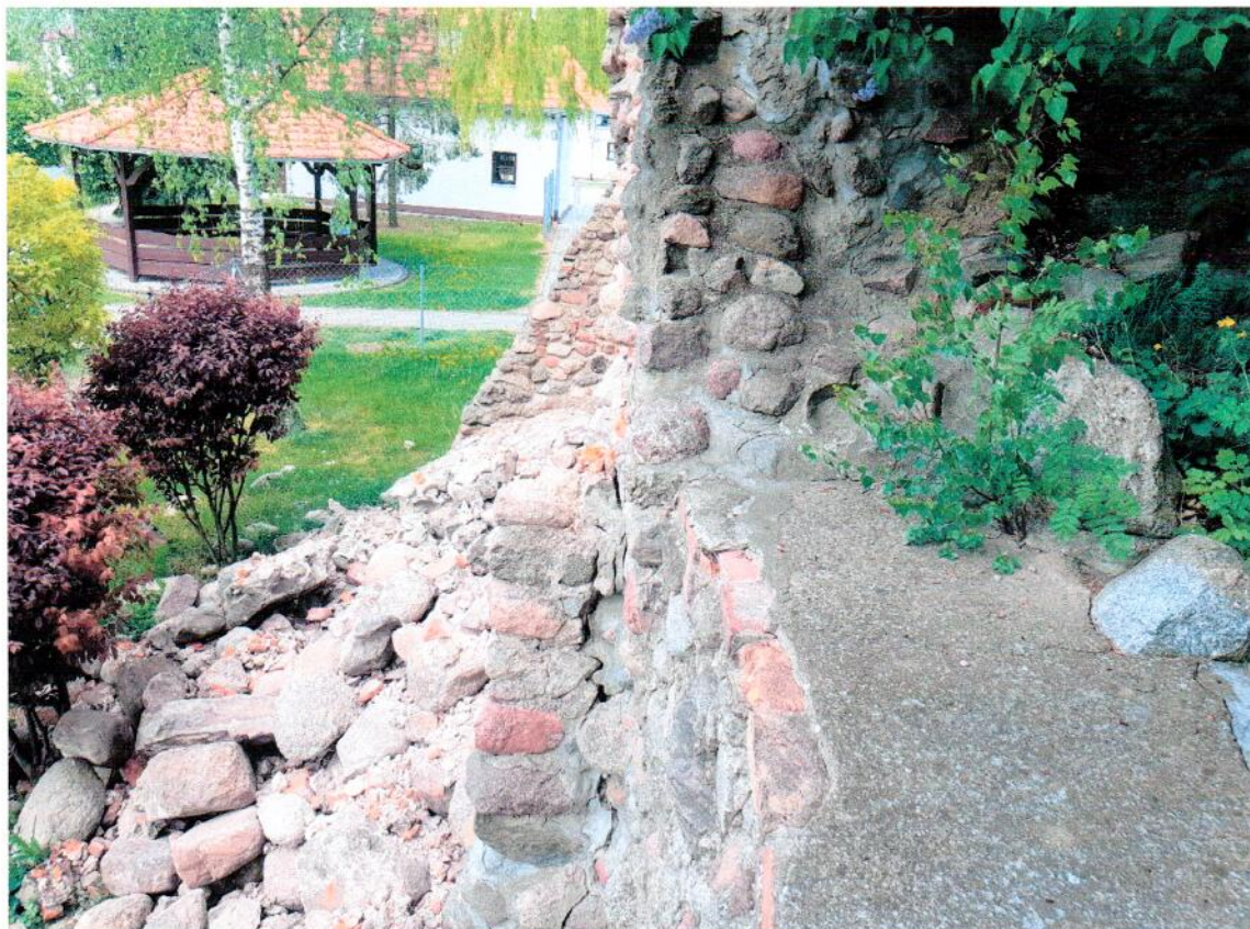
Fot. 48. Fragment południowy uszkodzonego muru przedzamcza z poziomu korony muru od strony ul. Fosa Jagiellońska
