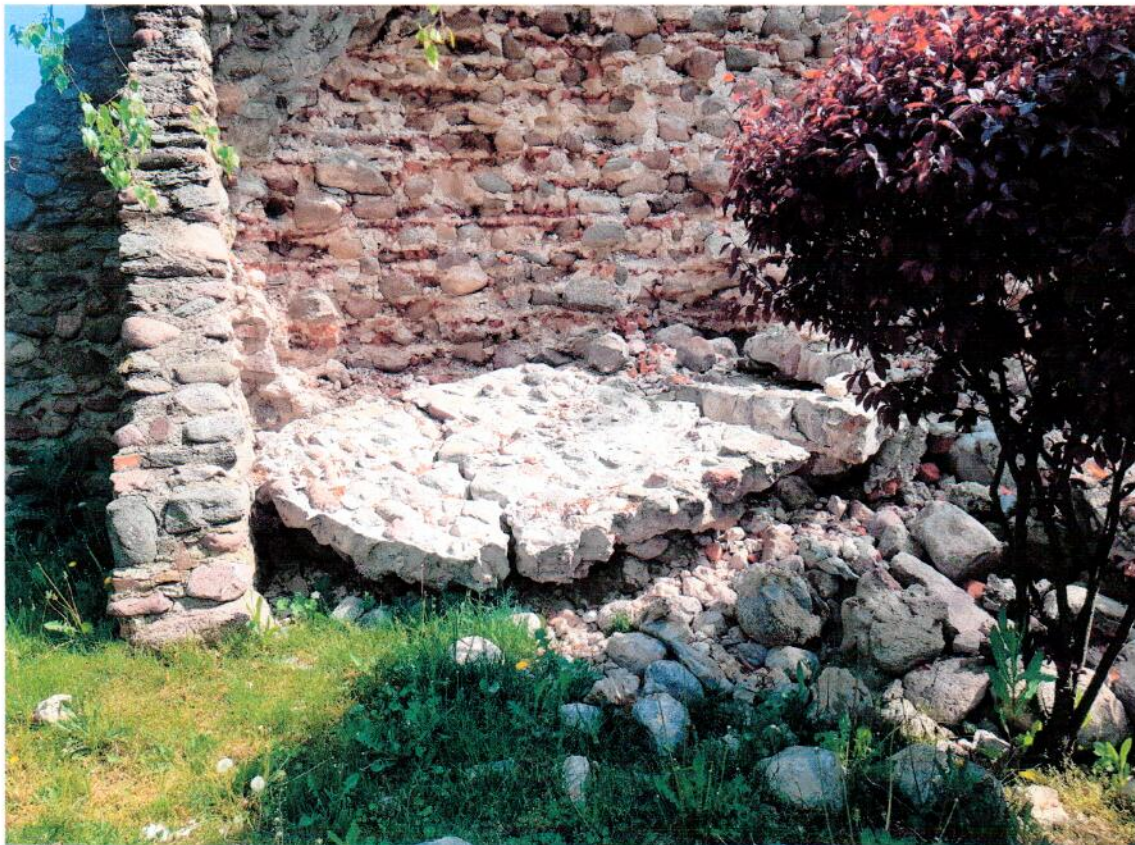
Fot. 42. Fragment narożny (południowo-zachodni) muru przedzamcza południowego od strony ul. Fosa Jagiellońska, stan po katastrofie budowlanej, fragmentem osuwiska
