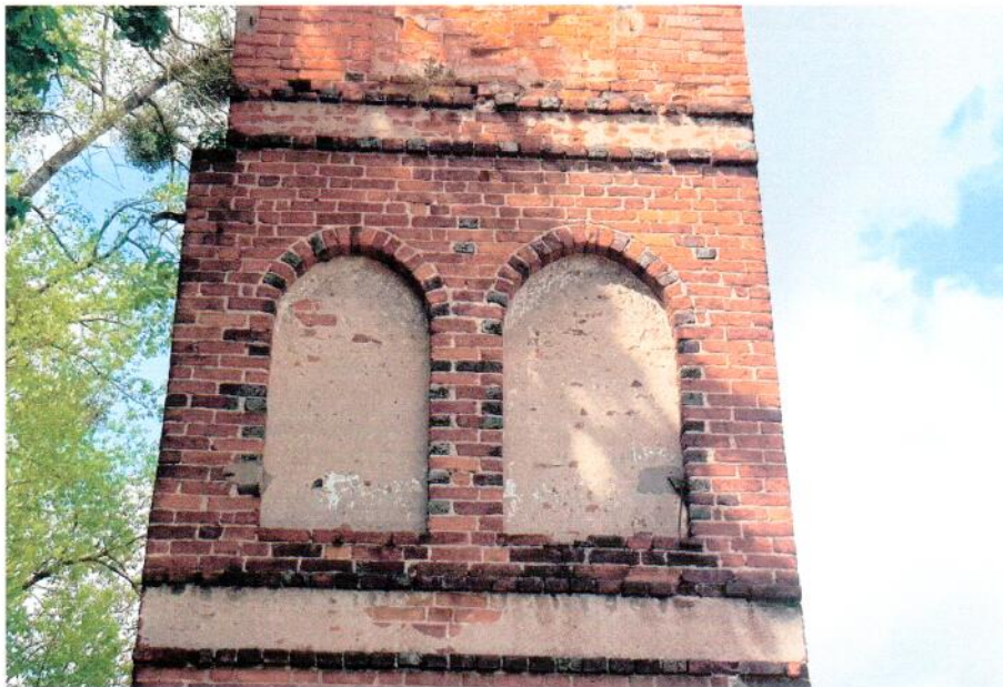
Fot. 14. Blendy i fryzy – widoczne ubytki wypraw tynkarskich
