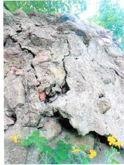
Fot. 27. Wtórne zaprawy cementowe pokrywające korony muru przedzamcza południowego
