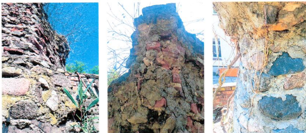
Fot. 21. Fragmenty baszty południowej przedzamcza środkowego, stan aktualny z widocznymi naprawami zaprawą cementową, uszkodzeniami wywołanymi porastaniem roślinnością jednoroczną i zdrewniałymi pędami krzewów
