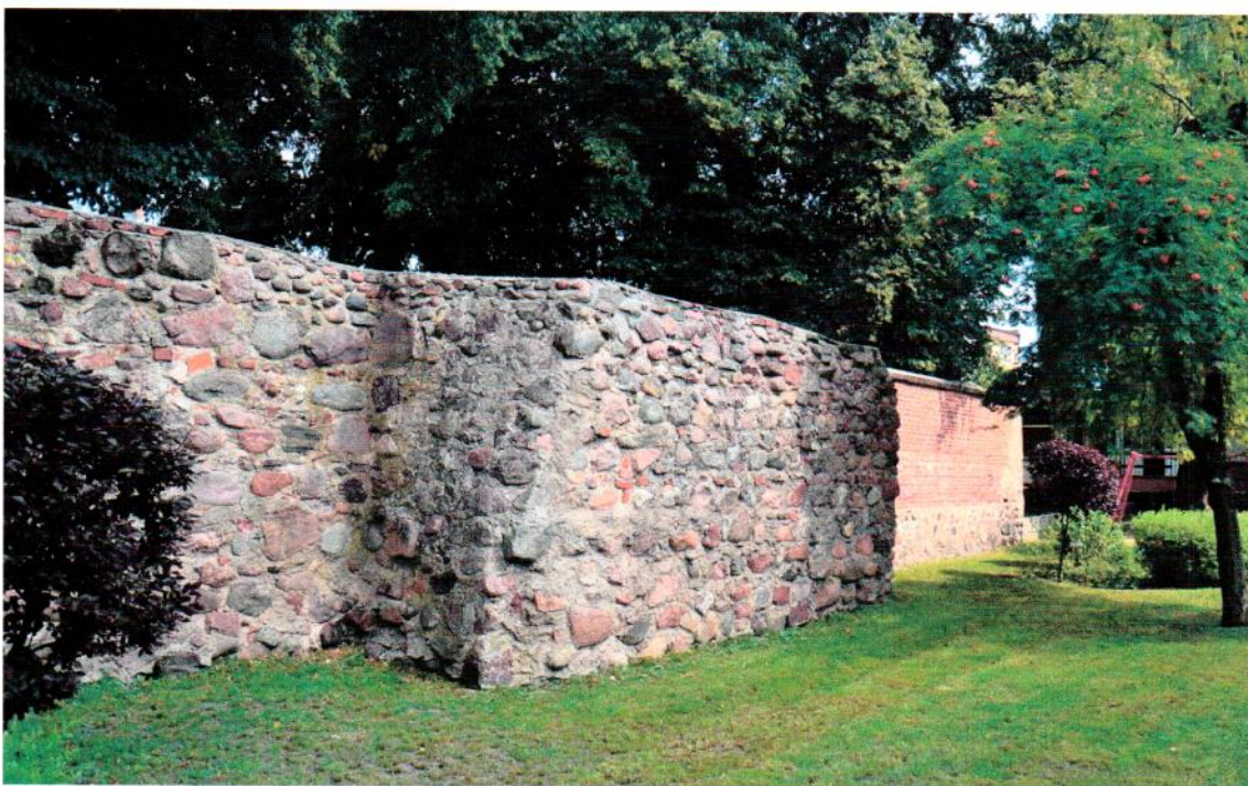
Fot. 39. Fragment muru przedzamcza południowego od strony ul. Fosa Jagiellońska, stan przed katastrofą budowlaną, źródło x dnia 18.05.2022 r.: https://polska-org.pl/7689808,foto.html?idEntity=7628467
