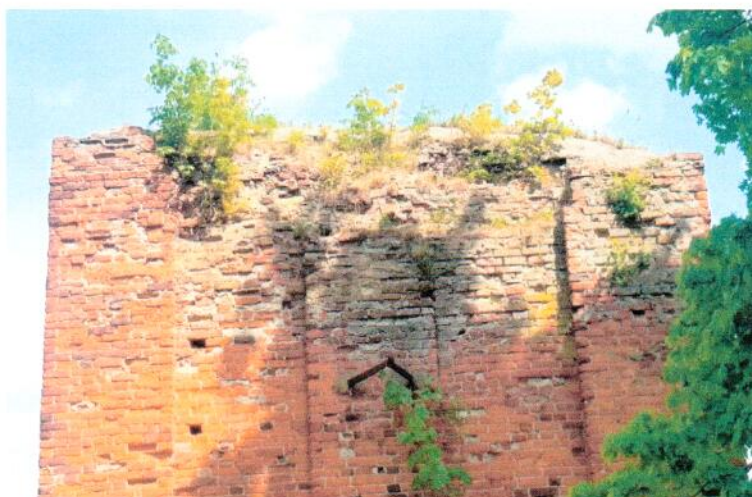
Fot. 12. Korona filaru gdańska silnie poprzeraśta roślinnością, widoczne zniszczenia muru, widok od strony południowej, z góry zamkowej
