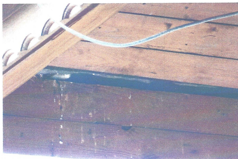
Fot. 2. Miejsce gniazdowe wróbla na skraju elewacji C. W szczelinie widoczny samiec z pary, a pod nią – duża ilość kału.
